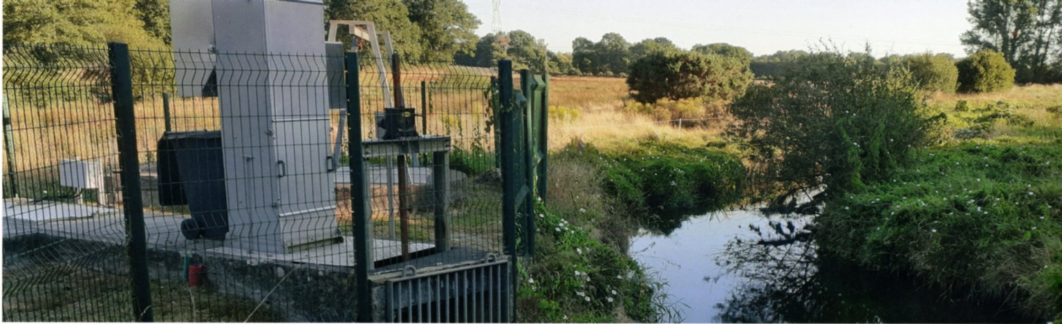
La station pompage dans l'Aven à Kerriou
